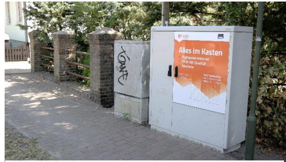
Schaltkasten im Ortsteil Derwitz
